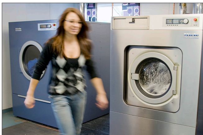
Förra året installerade Smålandsstenars Tvättinrättning AB nya miljövänliga tvättmaskiner och torktumlare.
